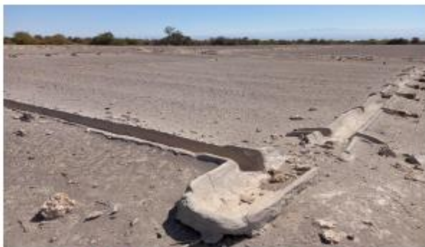
Imagen N° Restos de canales de riego sector Santa Ana, terreno 2021
