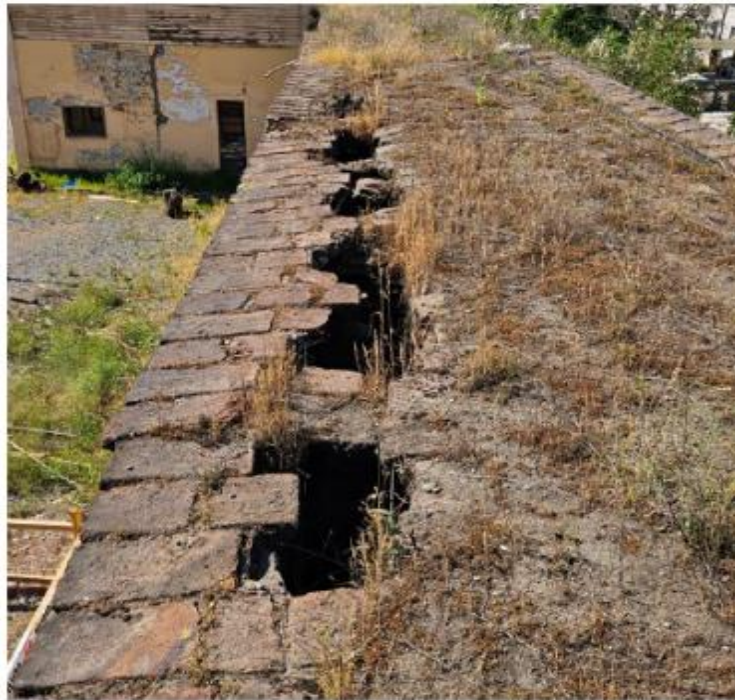
Figura 17. Áreas dañadas en cubierta de nichos.
