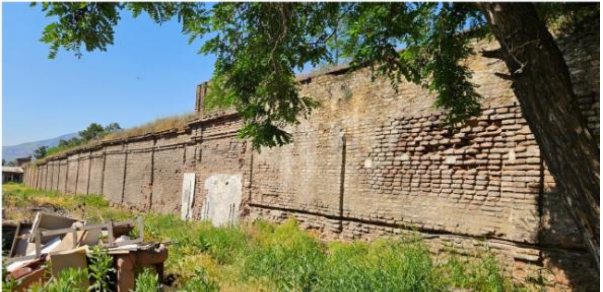
Figura 18. Vista muro con albañilería dañada.
