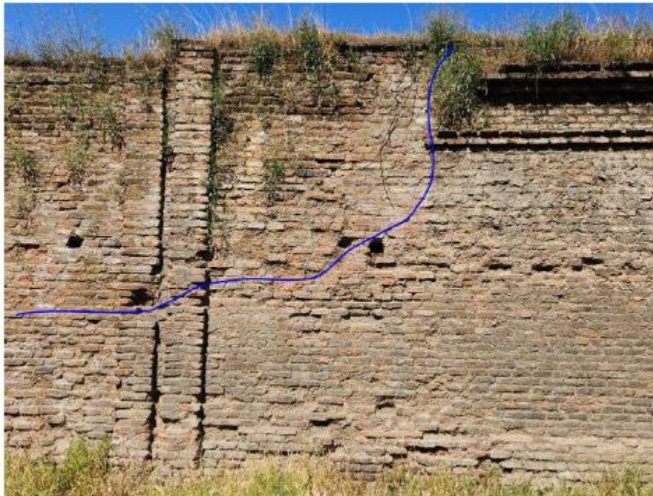
Figura 19. Término de cornisa y su evidente deterioro.
